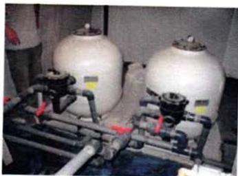
Foto 23. Filtre mecanice cu cuarț tip "Crystal" cu capacitatea de filtrare de 30 m 3 /h
