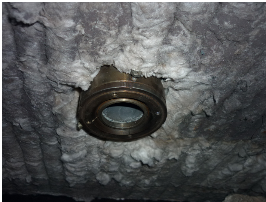
Figura 5.3. Vedere interioară a cuptorului (generatorul sonic este amplasat în tavanul cuptorului).
